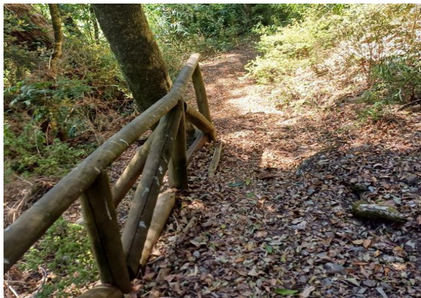
Foto 12. Infraestructura de sendero en mal estado, ej. 1.
