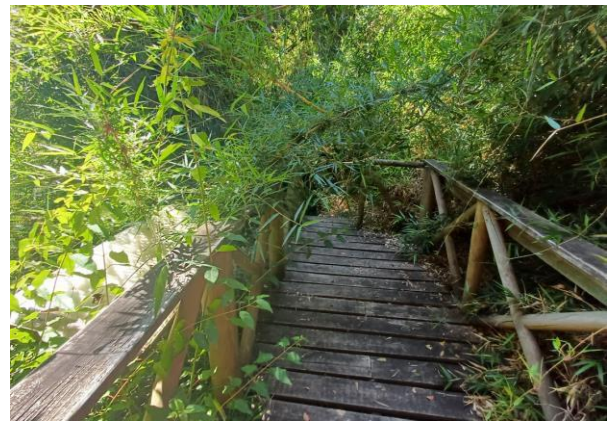
Foto 13. Infraestructura de sendero en mal estado, ej. 2.
