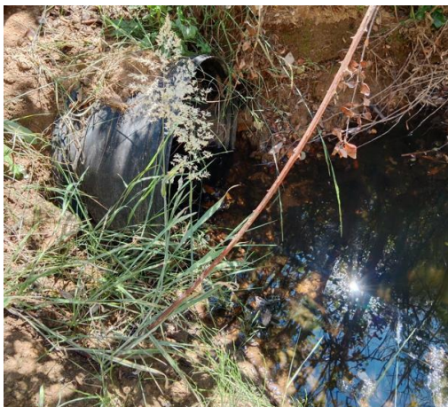
Foto 5. Acumulación de agua por mal drenaje.
