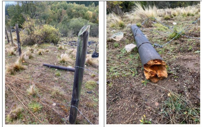
Figura 2. Rotura cerco perimetral.
